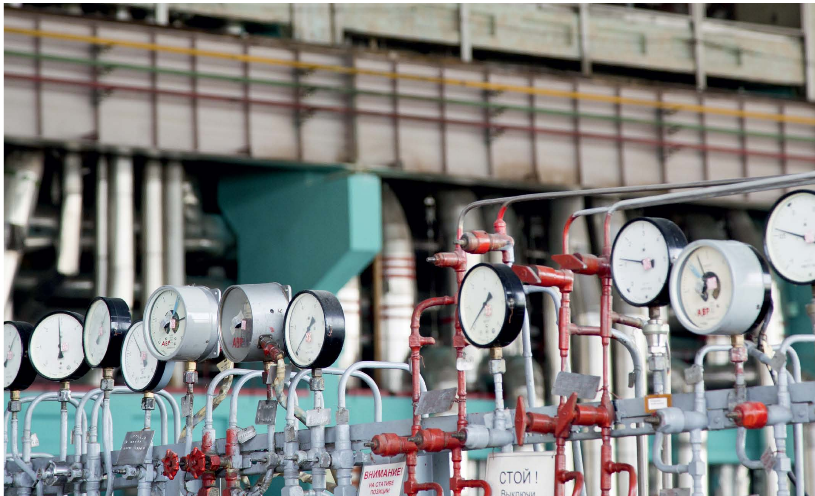
Машинный зал энергоблока №3, Белоярская АЭС
